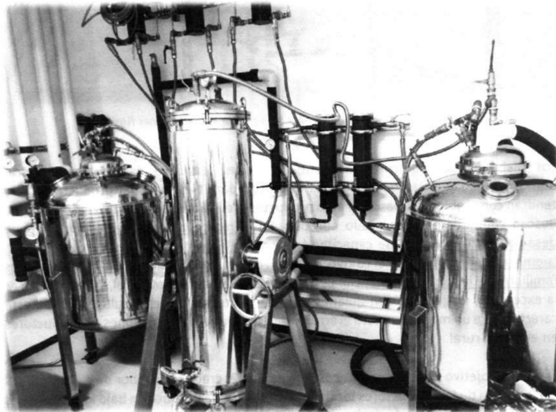
Figura 3 - Partes del sistema de Remediación (Unidad 1) a alojar en las instalaciones existentes del Parque
